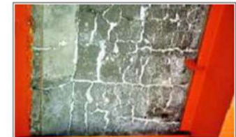
(d) Water leakage and free lime
